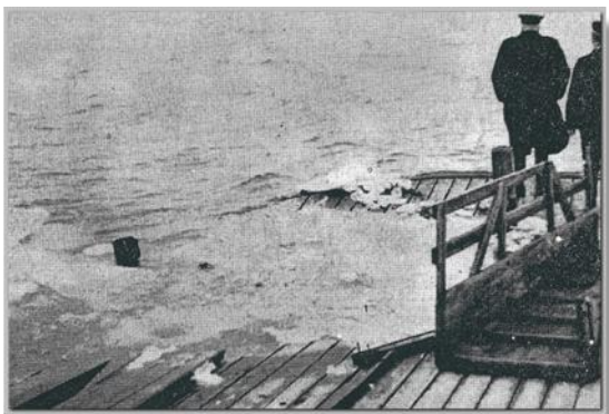
Fig.2.) Postmester Stokholm og sognerådsformanden på Alrø besigtiger skaderne den 24.3.1940. Her ses selve brohovedet.
